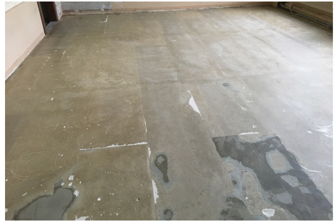
Alter Sanierungsbedürftiger Untergrund.
